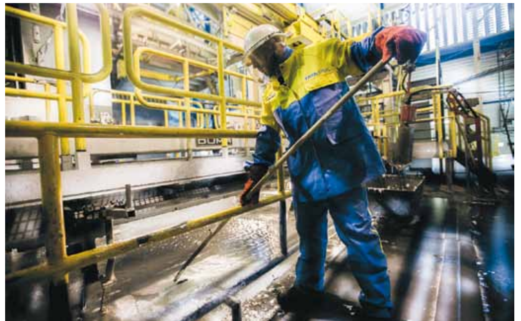
Een medewerker, gehuld in beschermende kleding en een masker, bij de Dompelverzinklijn 3 van Tata Steel in IJmuiden, waar het staal van een laag zink wordt voorzien als bescherming tegen corrosie.
